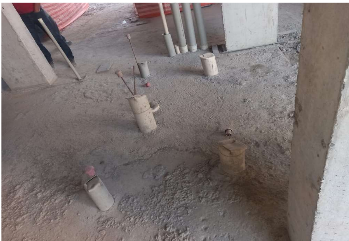
Figura 2: risco de acidentes
