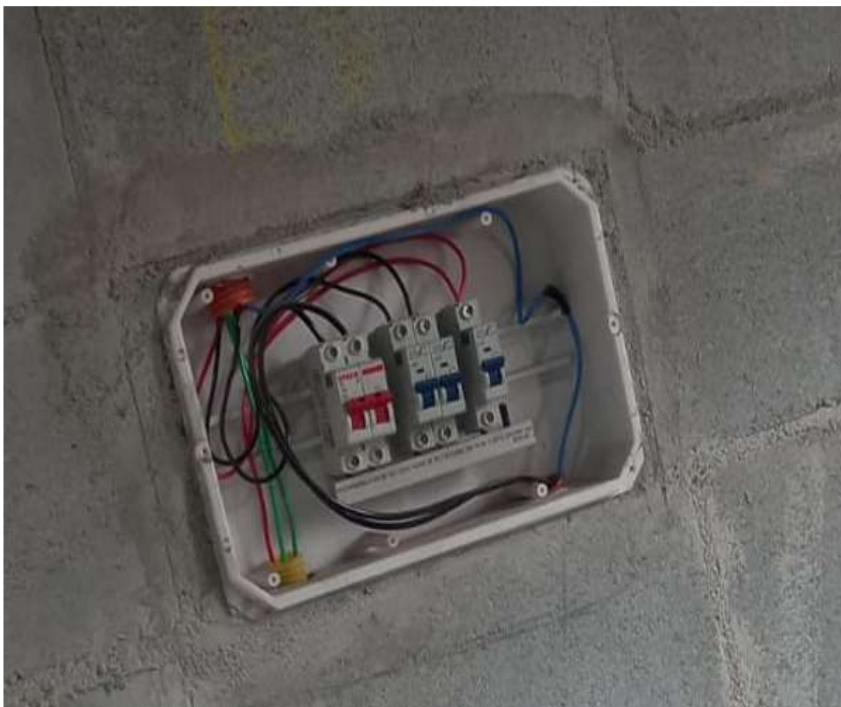
Figura 5: risco de acidente
