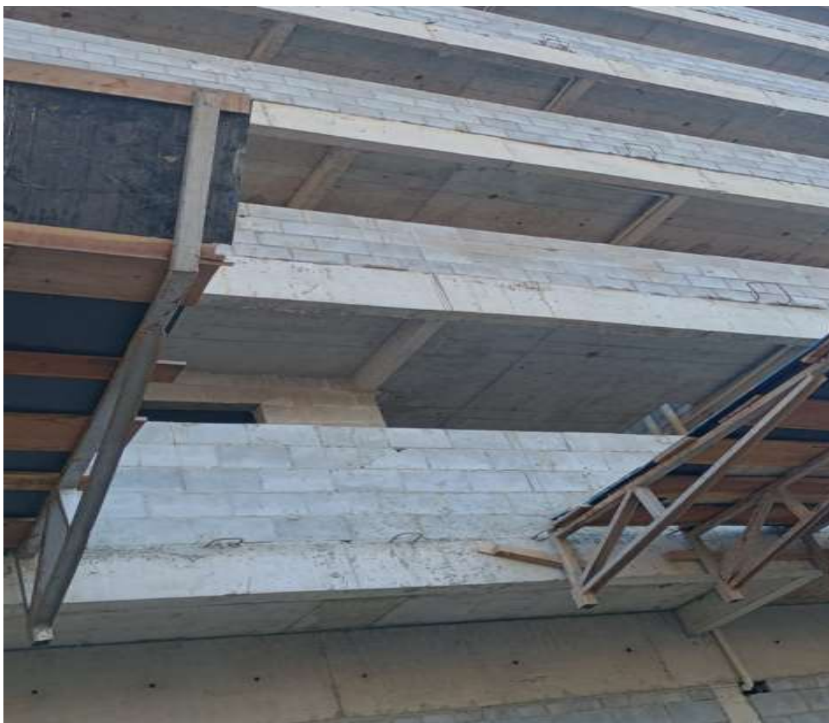
Figura 7: risco de acidente
