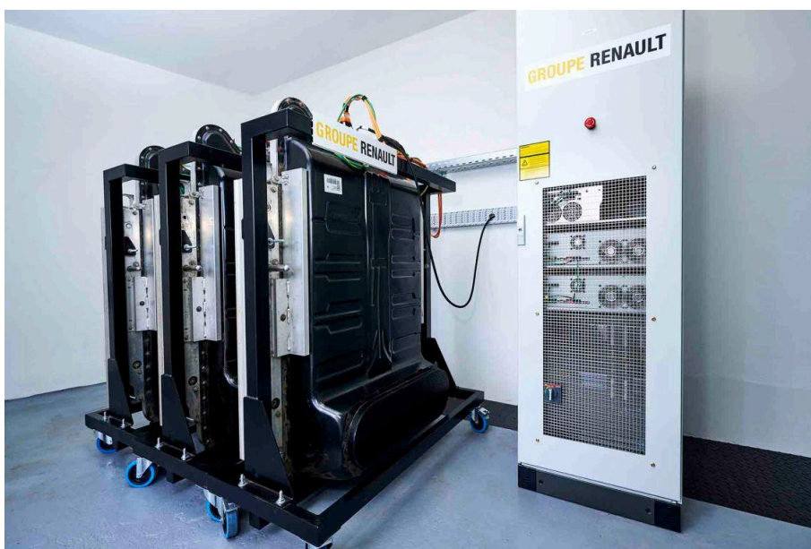
Figura 12 - Arranjo de baterias de segunda via para fins de armazenamento.
