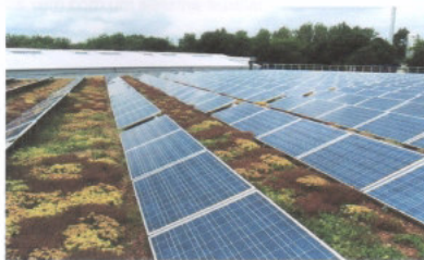
Figura 6- Telhado verde com placas fotovoltaicas
