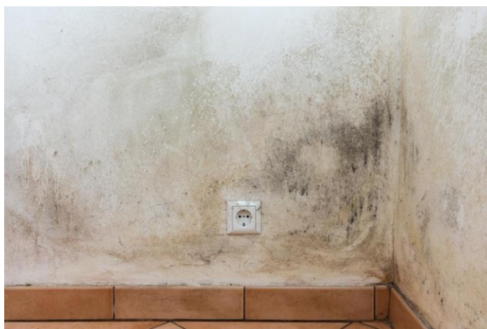
Figura 4- Mofo em paredes
