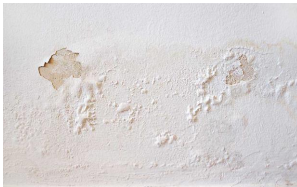
Figura 3- Umidade na parede
