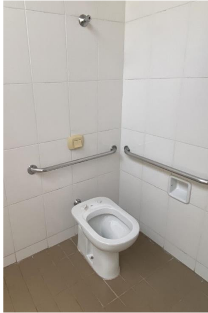
Figura 5: Vaso sanitário quebrado em banheiro da quadra (adaptado pelo autor).
