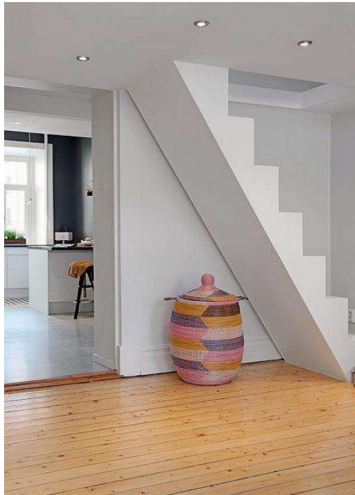
Fotografia 1 – Escada íngreme e sem corrimão (barreira arquitetônica).
