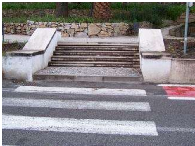
Fotografia 2 – Calçada sem rebaixamento e com escadas para acesso à via.
