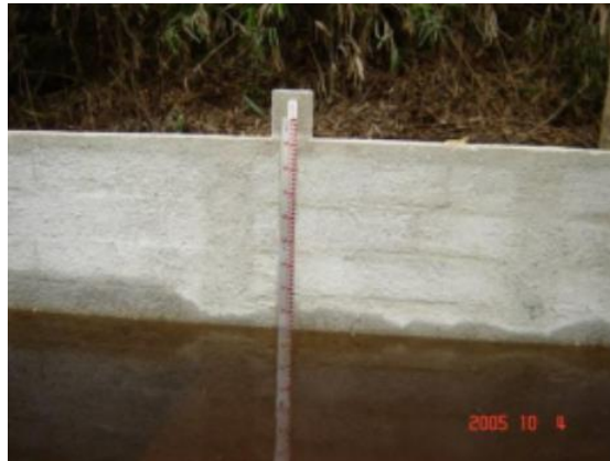
Figura 21. Régua linimétrica instalada na parede do tanque principal de sedimentação e tranquilização de fluxo.
