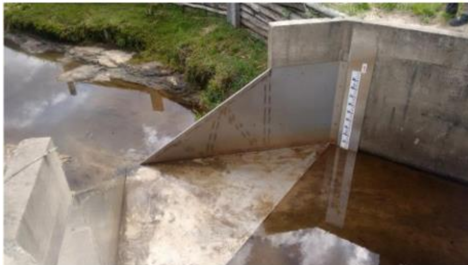
Figura 26. Visão do interior do vertedor (UPM 2023)
