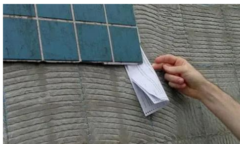
Figura 11 - Estufamento de revestimento cerâmico
