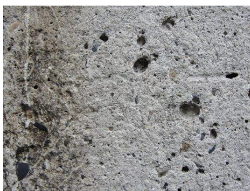
Figura 4 - Porosidade no concreto
