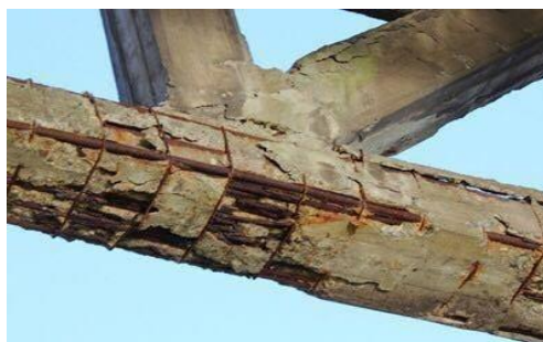
Figura 8 - Carbonatação do concreto – área externa
