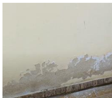
Figura 36 - Eflorescência na parede.
