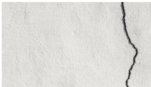
Figura 2 - Trincas na alvenaria
