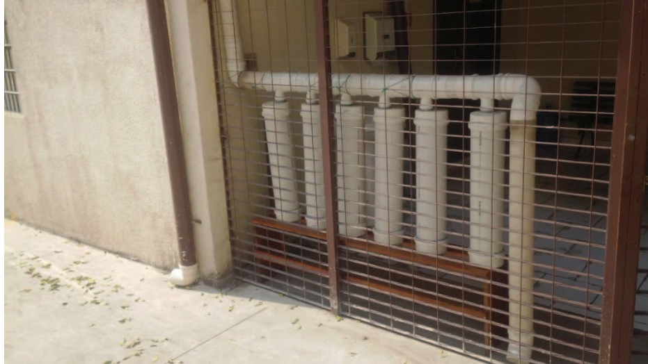
Figura 35. Coletor do escoamento inicial de água de chuva instalado
