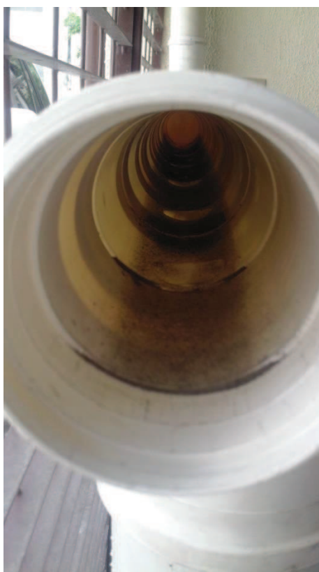
Figura 47. Presença de sólidos particulados na tubulação horizontal do coletor de água de chuva
