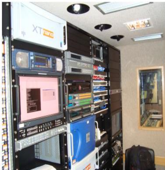
Figura 14 - Interior do veículo com racks e equipamentos de transmissão
