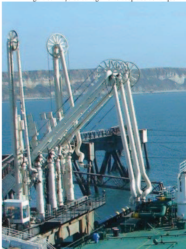
Figura 5. Braço de carregamento acoplado ao tanque
