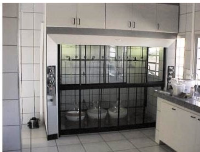
Figura 15 – Central de tratamento de resíduos químicos da USP – São Carlos, visão interna.
