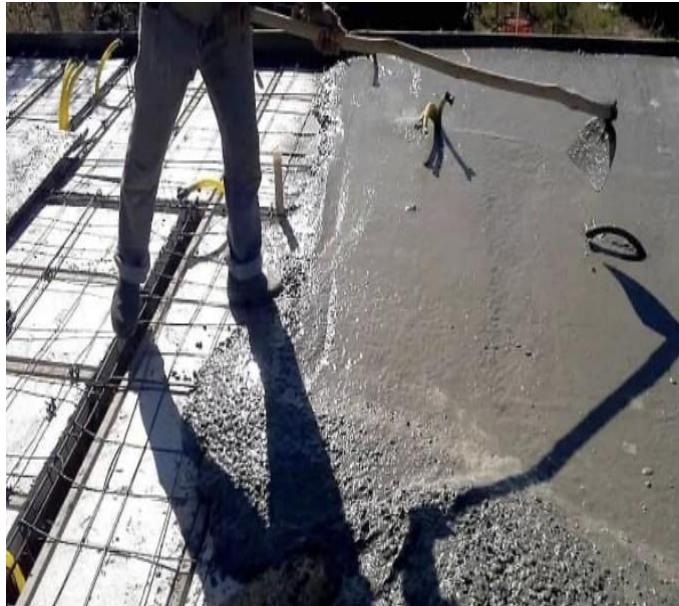
Fonte: Laje de Isopor. Viva Decora. 2020. Disponível em: Figura 27 - Concretagem de laje EPS
