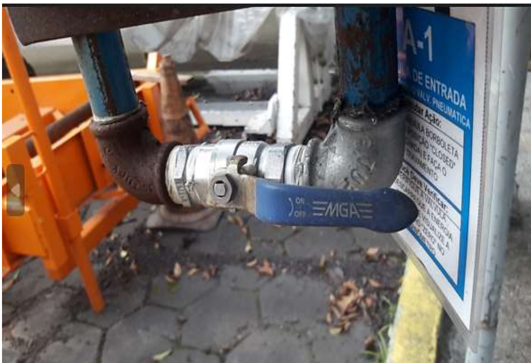
Figura 5.4 - Implementação da Válvula Esfera de 3/4" para Alimentação do Ar Comprimido
