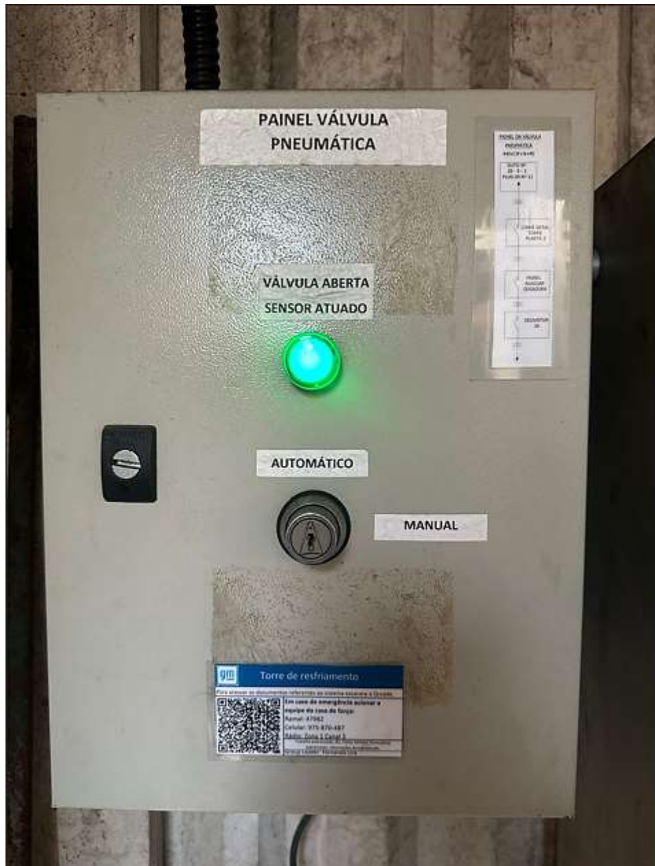
Figura 5.2 - Implementação do Painel Elétrico Auxiliar (Porta Fechada)
