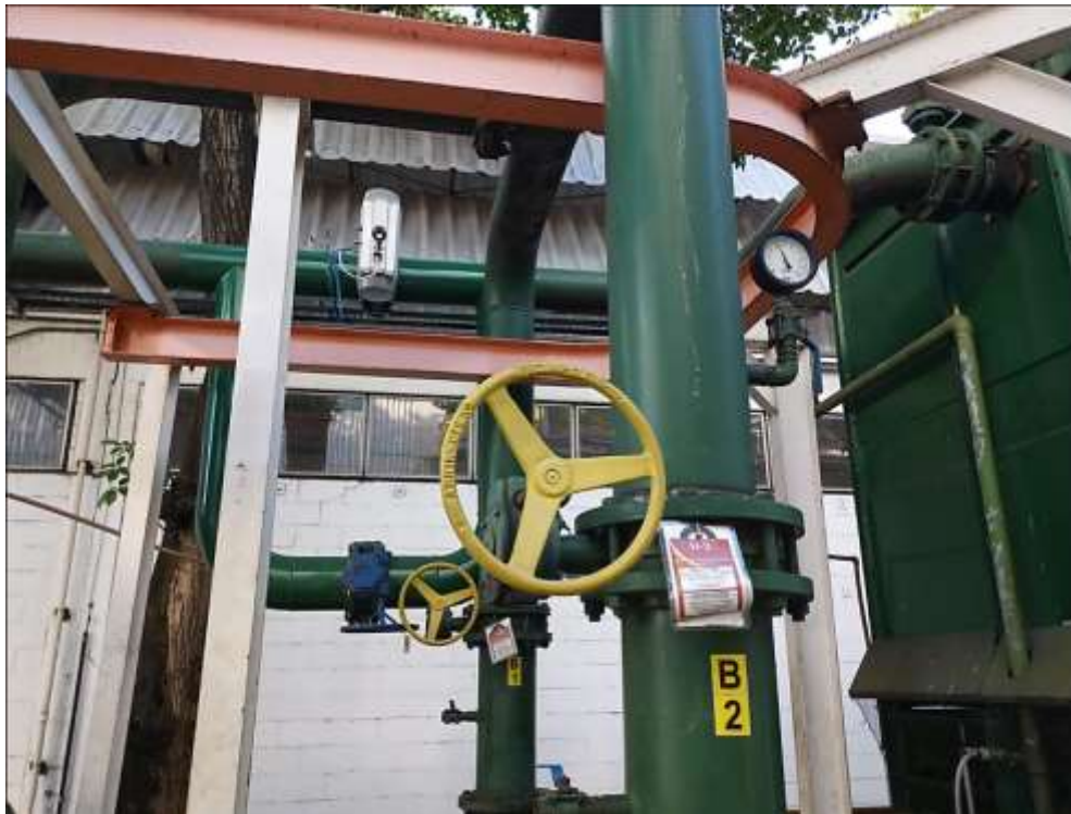
Figura 5.5 - Implementação da Válvula de By-pass e da Válvula Eletropneumática (Vista Frontal)
