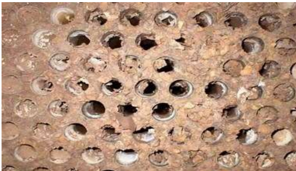
Figura 3.12 - Trocador de Calor com Acúmulo de Biofilme.
