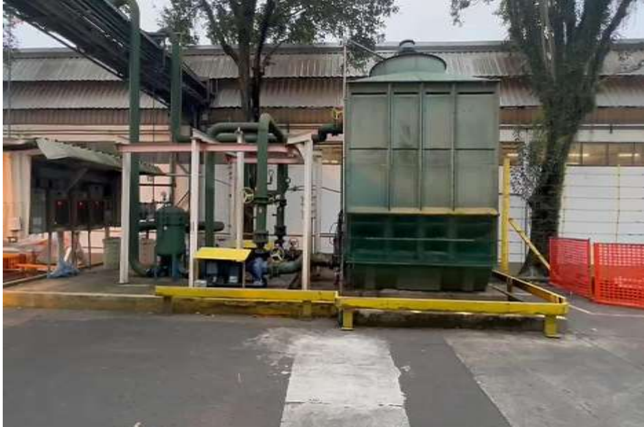
Figura 4.1 - Torre de Resfriamento (Planta 03)
