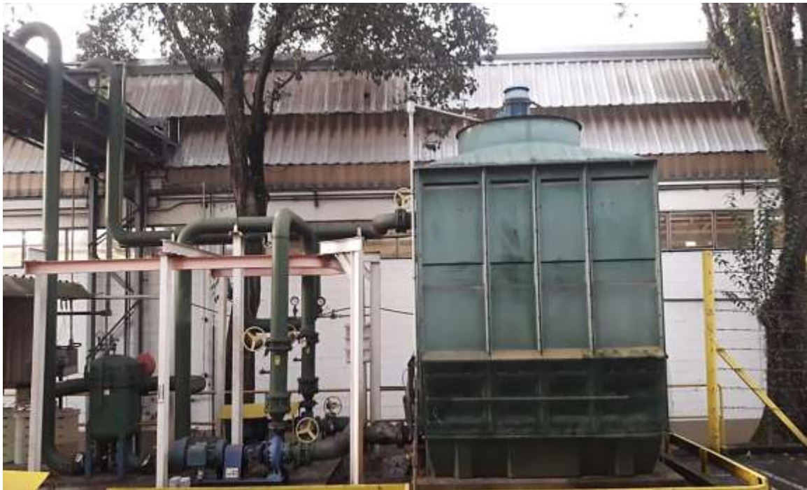
Figura 4.12 - Sistema Hidráulico Antes da Implementação da Válvula Eletropneumática (Vista Frontal)
