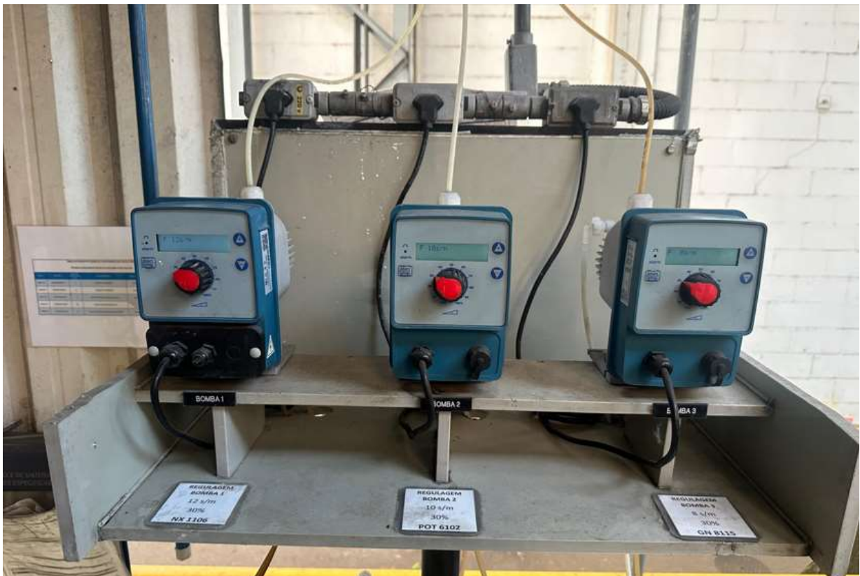
Figura 4.7 - Conjunto Montado das Bombas de Dosagens Tekba - Seko
