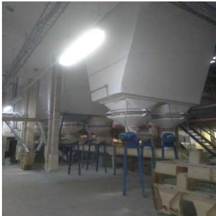
Figura 11 - Silo de armazenamento de farinha
