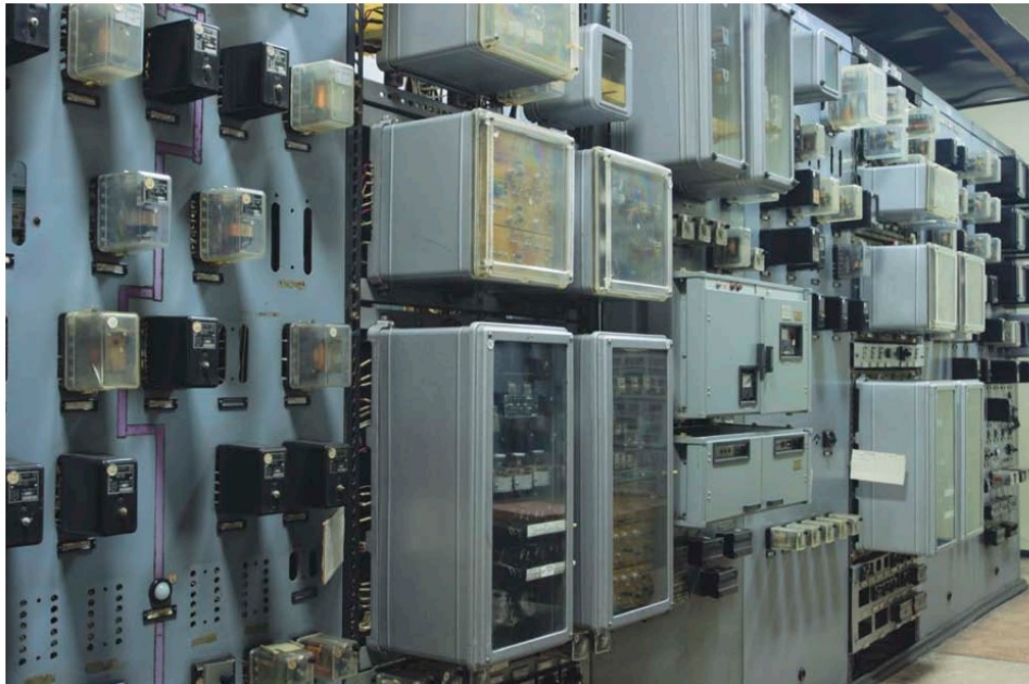
Figura 2: painéis de relés e contadores
