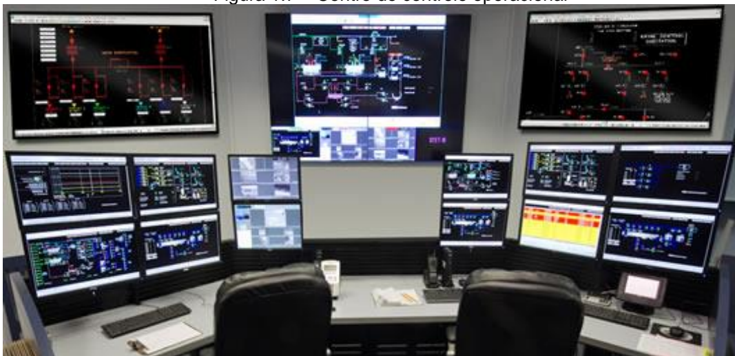
Figura 1.7 – Centro de controle operacional
