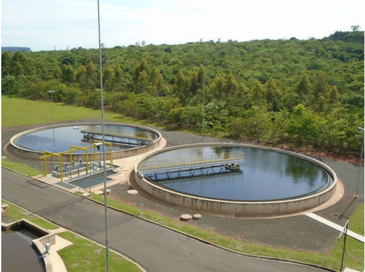
Decantador Secundário. / Foto: SESAMM – Serviços. de Saneamento de Mogi Mirim
