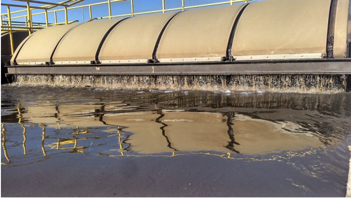
Tanque de Aeração. / Foto: SESAMM – Serviços de Saneamento de Mogi Mirim.
