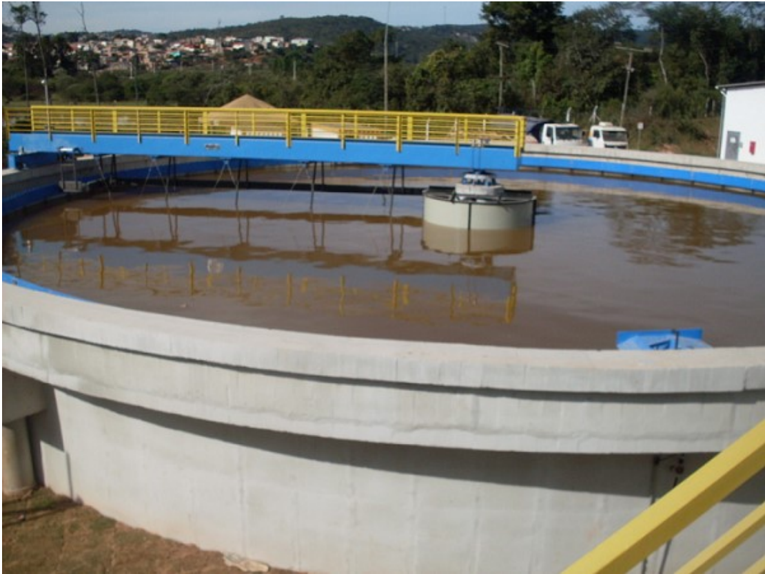
Decantador Primário. / Foto: ALEH Saneamento e Arquitetura.
