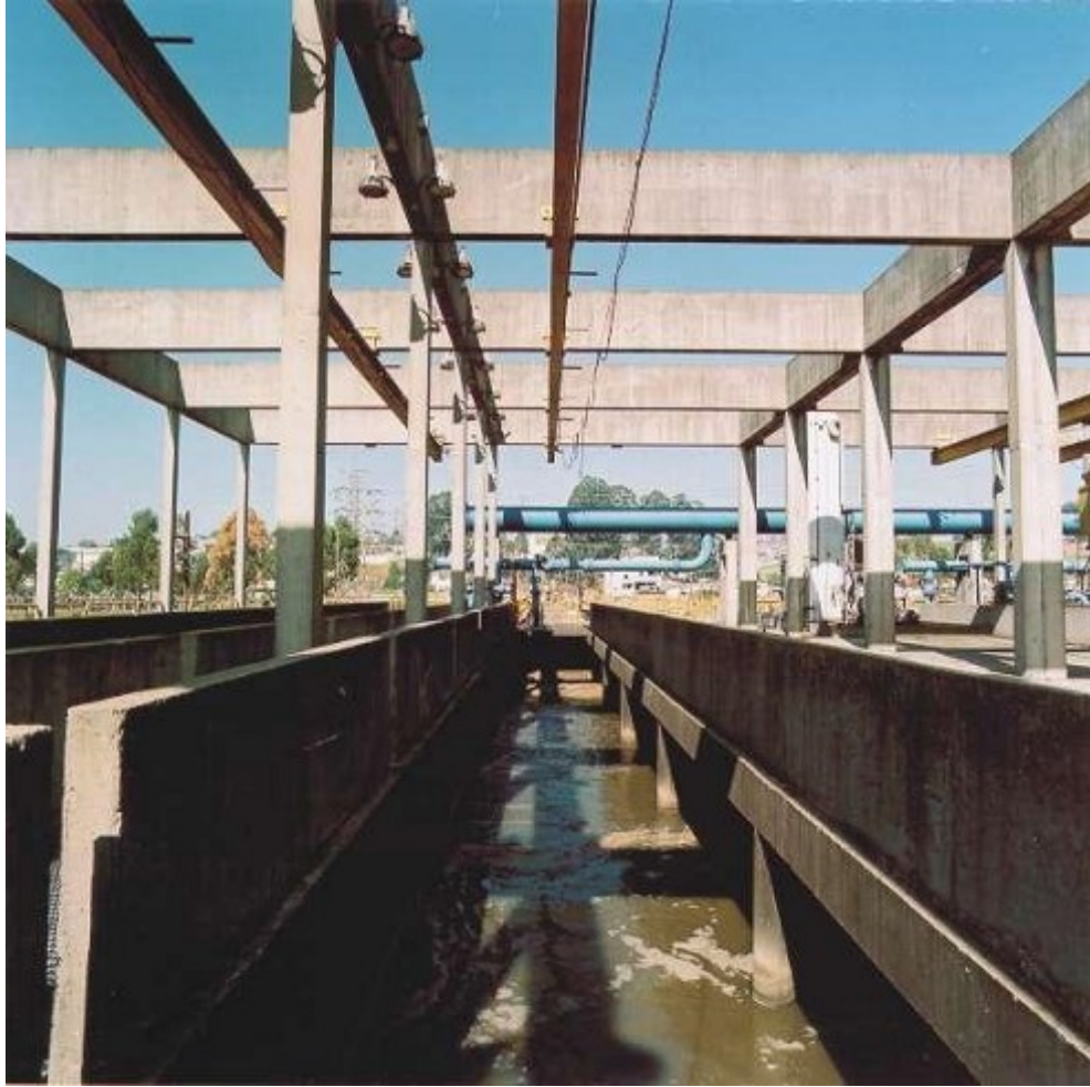
Etapa de Desarenação. / Foto: SOUZA, Weverton Gesiel de (2012).
