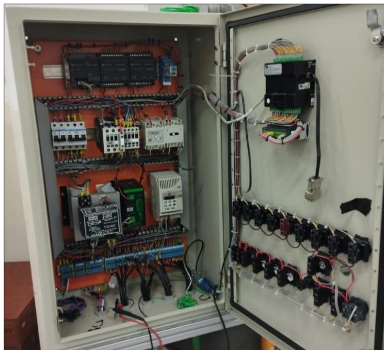
Figura 3.6 – Painel elétrico após as adequações iniciais
