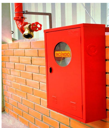
Figura 8 - Hidrante de abrigo
