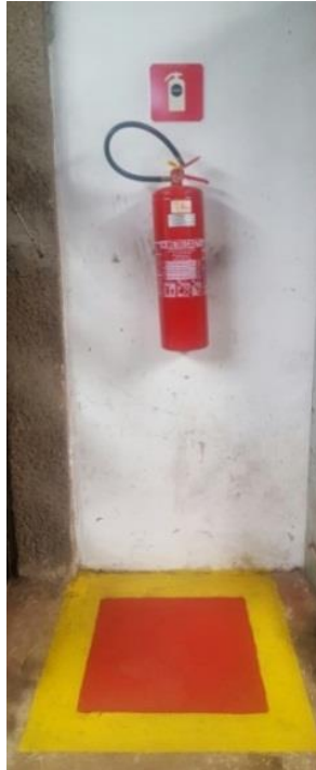
Figura 5. Extintor devidamente instalado
