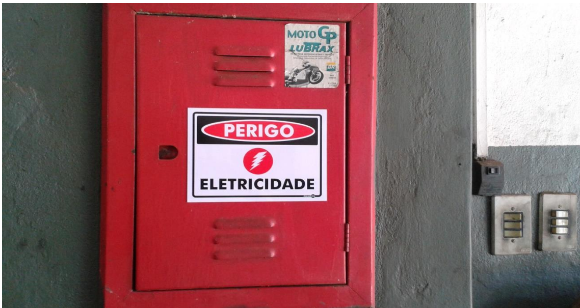
Figura 16. Sinalização dos quadros de energia elétrica (após a implantação).
