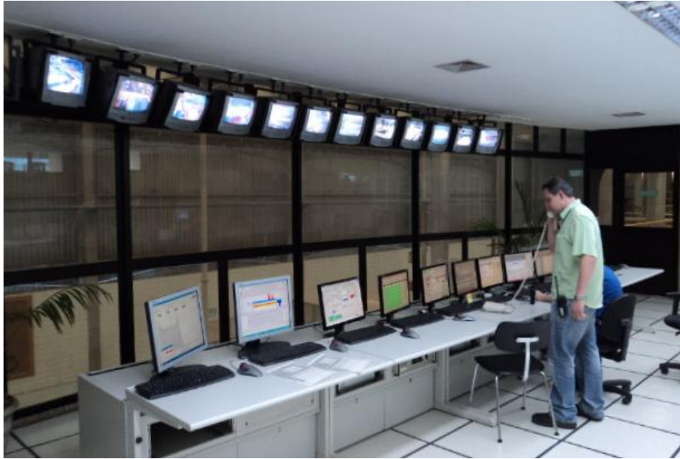
Figura 9- Sala de controle
