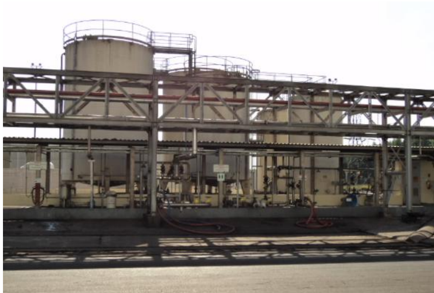
Figura 11- Tanques de armazenagem
