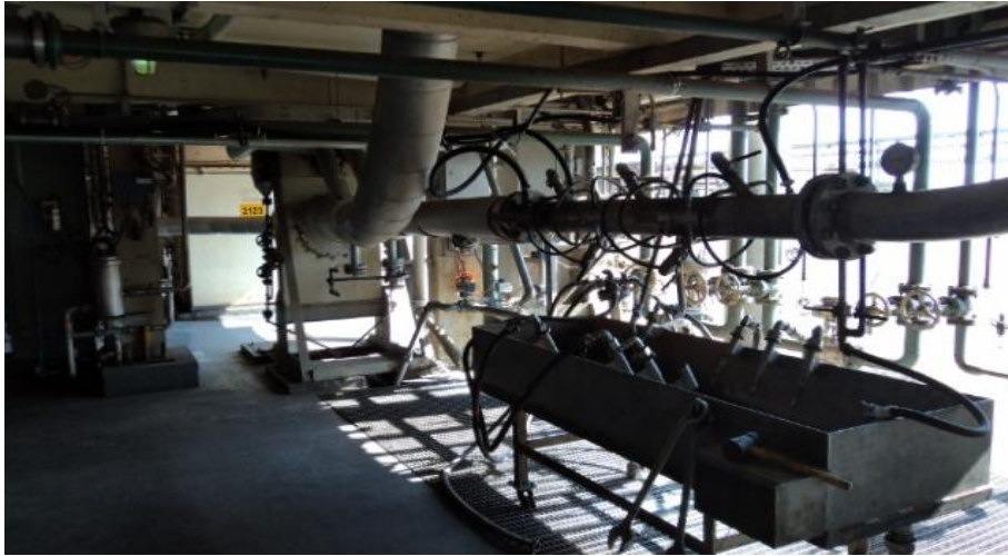
Figura 7- Linha de injeção de aditivos
