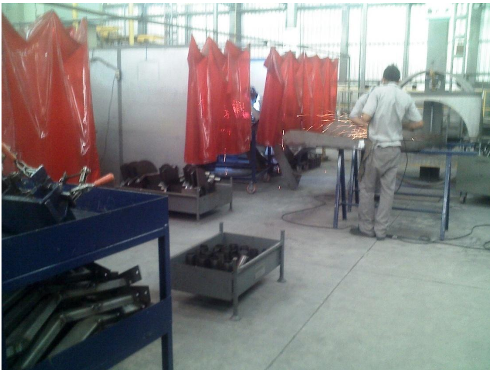
Figura 5. Box de solda de maior porte
