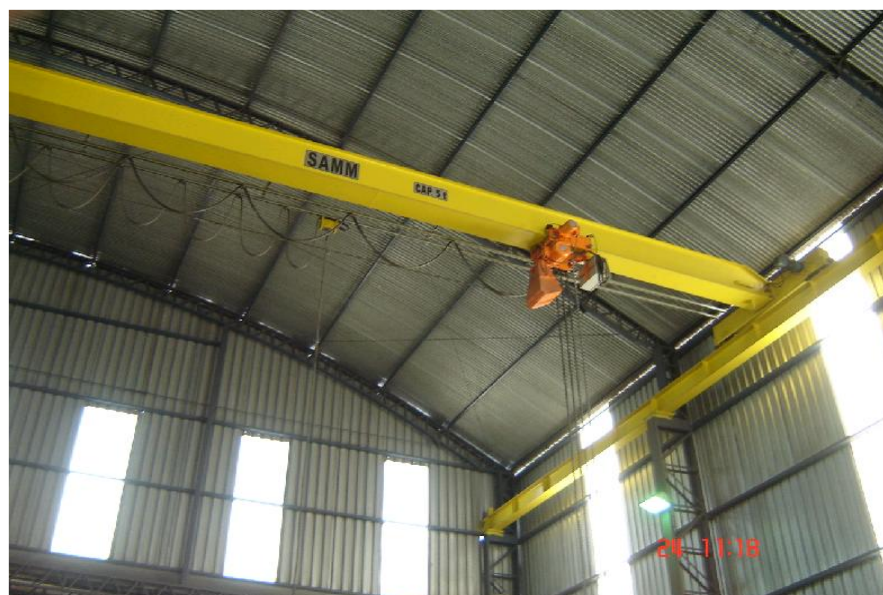
Figura 11 – ponte rolante existente na empresa
