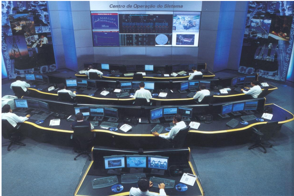
Centro de Operação de Sistemas (COS) da CPFL em Campinas
