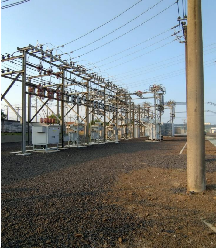
Subestação São Carlos SCA 11,9 Kv (CPFL)
