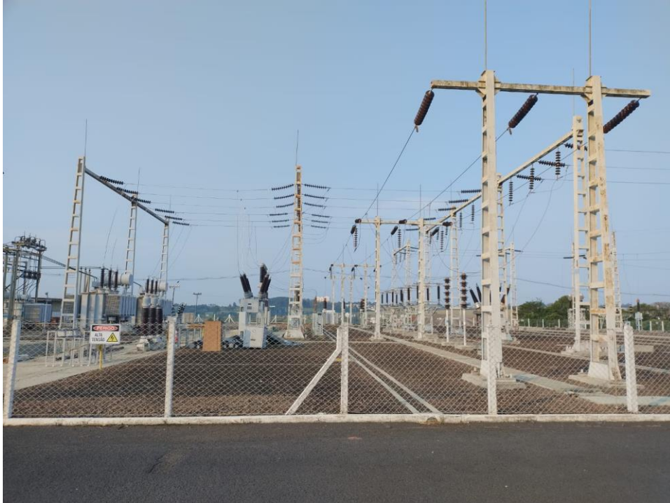
Barramentos Subestação São Carlos SCA 11,9 Kv (CPFL)
