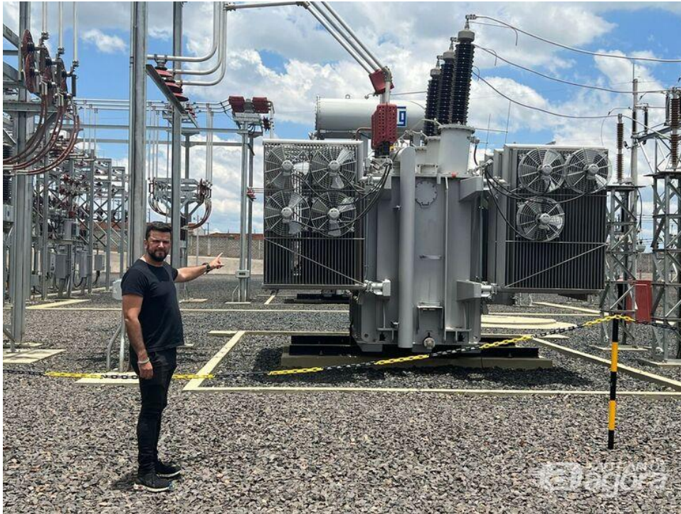
Transformador subestação Bela vista São Carlos BLV (CPFL)
