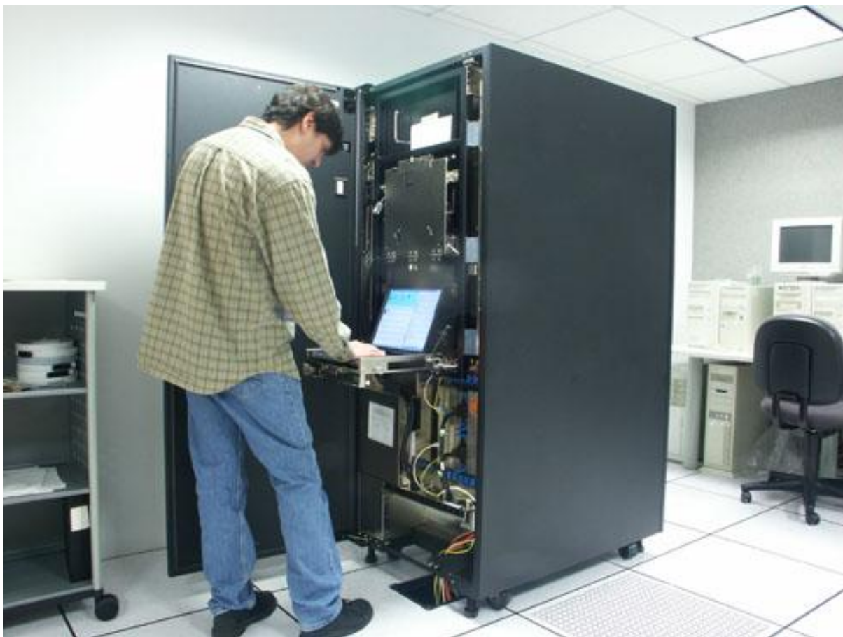
Figura 3: Engenheiro acessando o HMC através da SE
