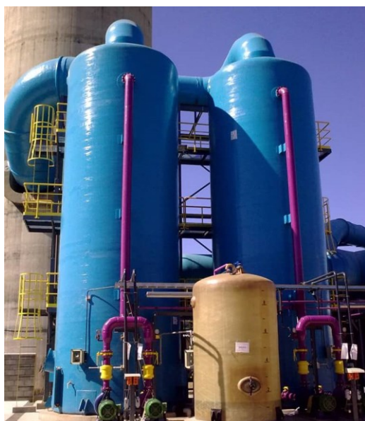
Figura 4: Lavador de gás tipo coluna absorção.
