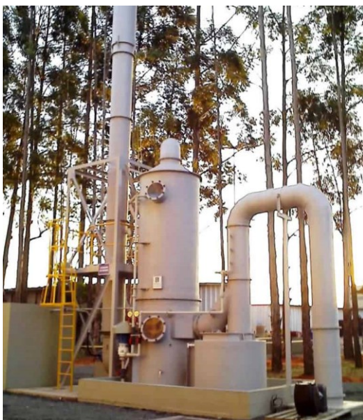
Figura 7: Lavador de gás tipo ejeter hidráulico.
