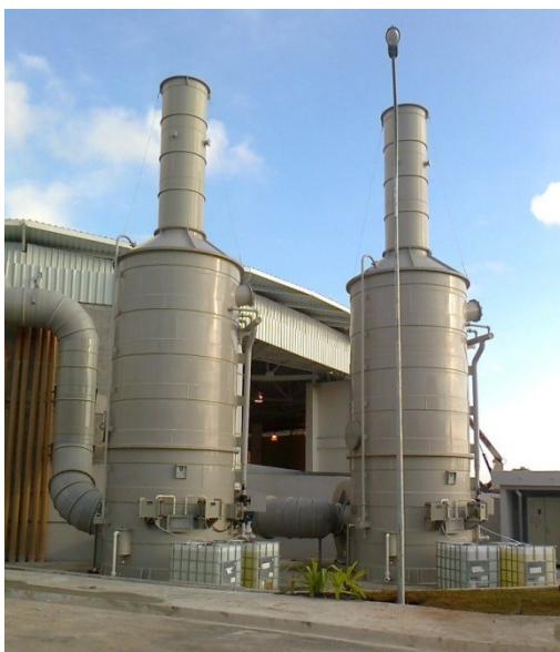
Figura 5: Lavador de gás tipo coluna de oxidação.
