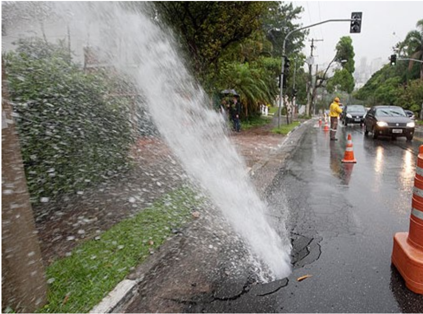
Figura 12: Tipo de vazamento visível em uma via
