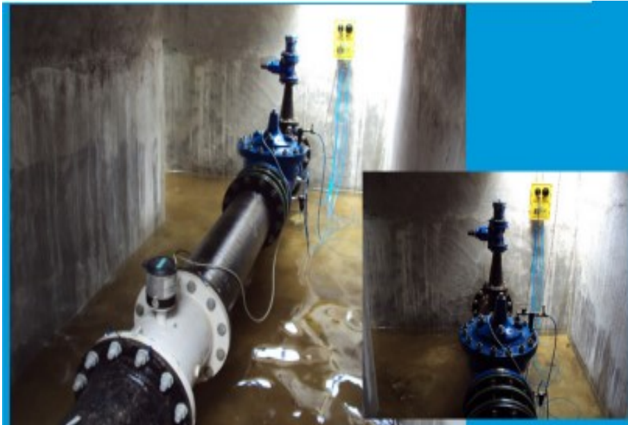
Figura 17: VRP instalada e regulada
