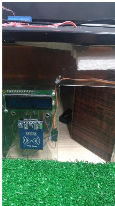
Figura 21 - Instalação elétrica (Porta - Sistema RFID)
