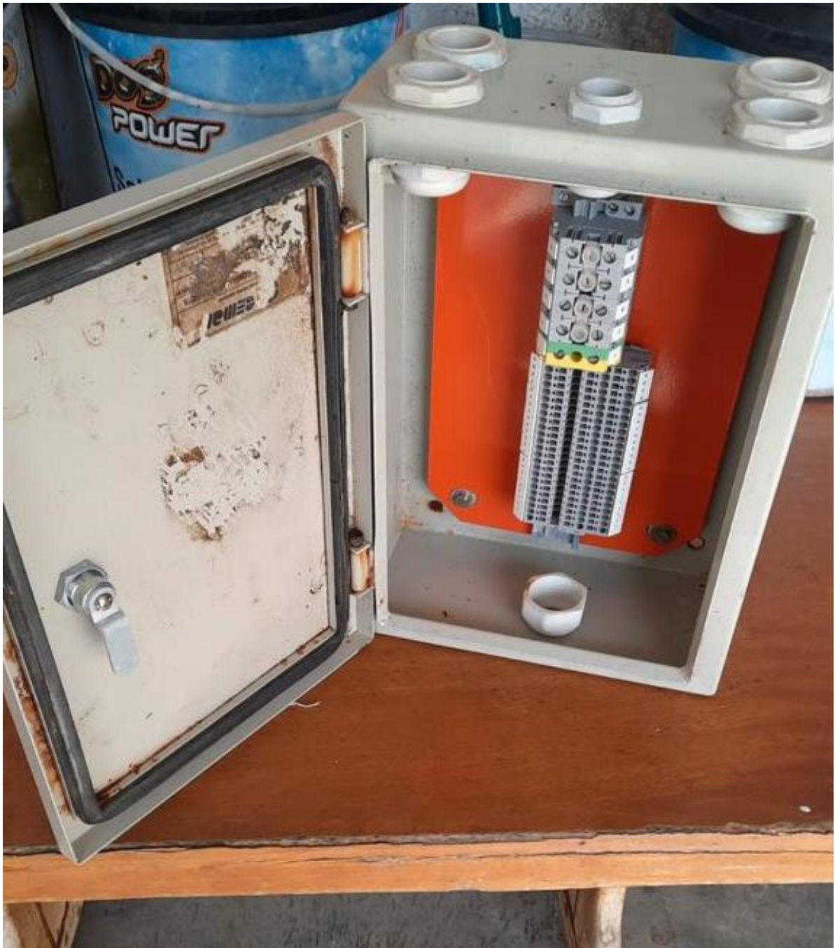
Figura 19 – Painel elétrico onde vai ficar a afiação, relés e o CLP.
