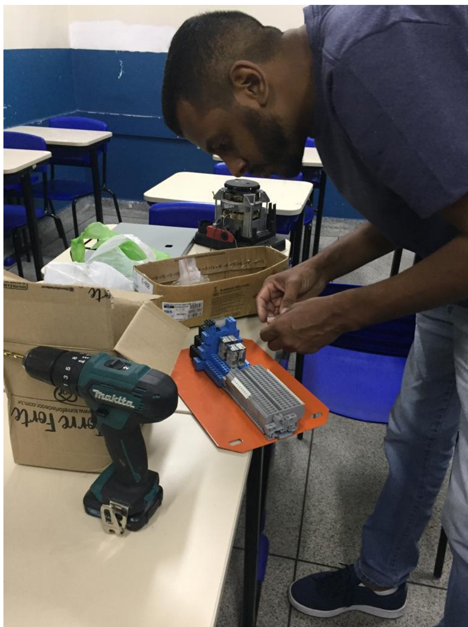
Figura 29 – Instalação dos relés na parte do painel elétrico do kit.
