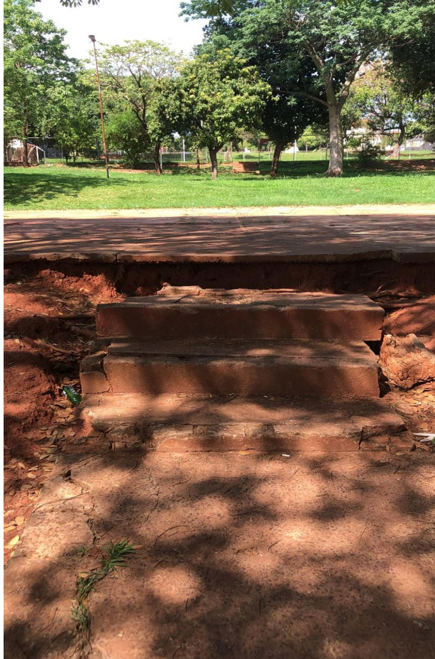
Fotografia 8 - Escadas em estado de desuso sem o último degrau.
