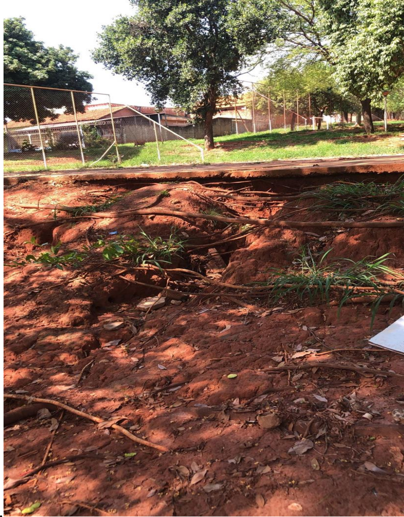
Fotografia 4 - Raízes externas por deslizamento.
