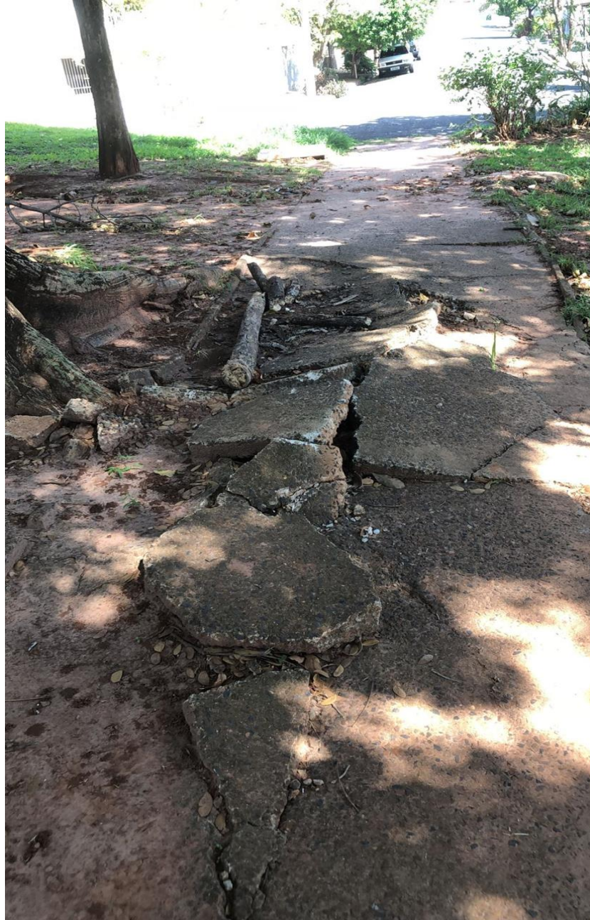
Fotografia 7 - Passeio com rachaduras.
