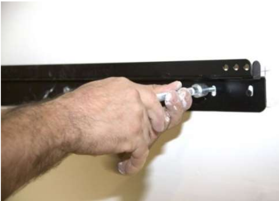
Figura 21 – Mostrando instalação específica em uma parede de Drywall
