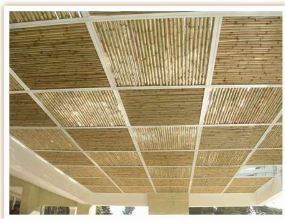
Figura 39- Forro de bambu em uma residência
