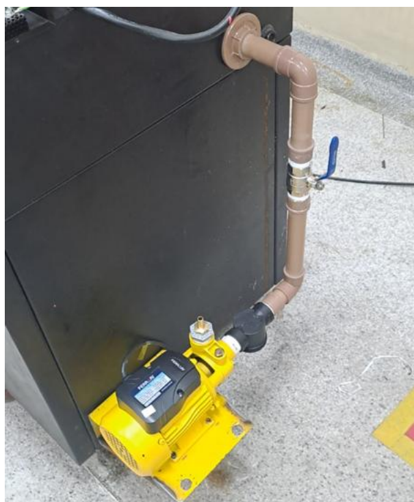
Figura 10 – Sistema de fluido com bomba operacionais
