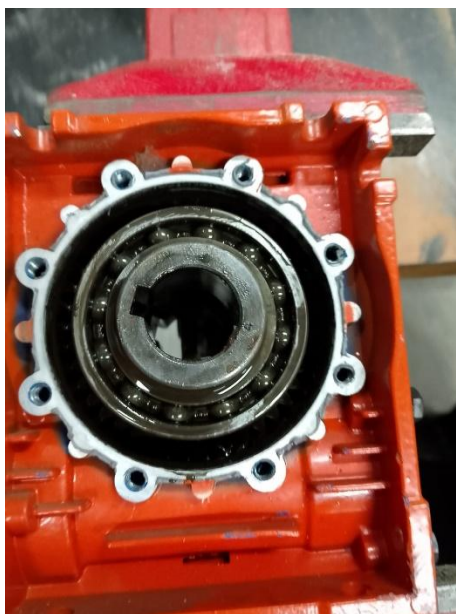
Figura 7 – Inspeção do conjunto redutor com evidência de desgaste nos rolamentos de suporte
