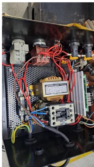
Figura 10 - Painel antes do relé de segurança NR12
