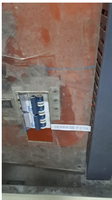
Figura 7 - Instalação da serra em um disjuntor separado
