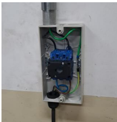
Figura 8 - Instalação da chave seletora lockout tagout
