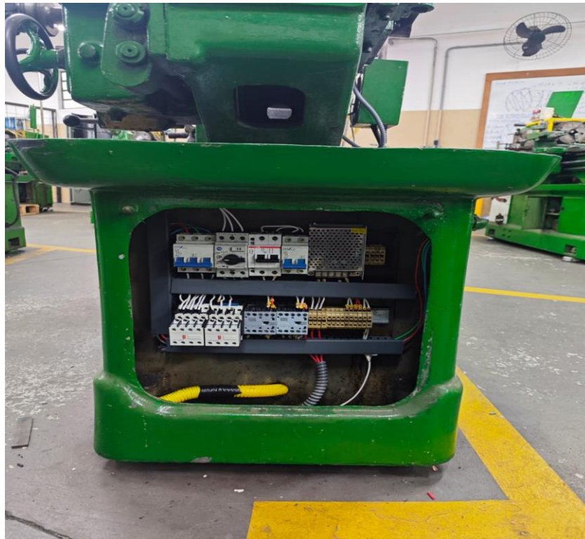
Figura 5 – Depois da Padronização (comando elétrico)
