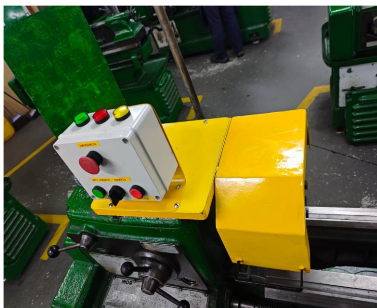
Figura 6– Depois da Padronização (sensor de tampa e sinaleiro)
