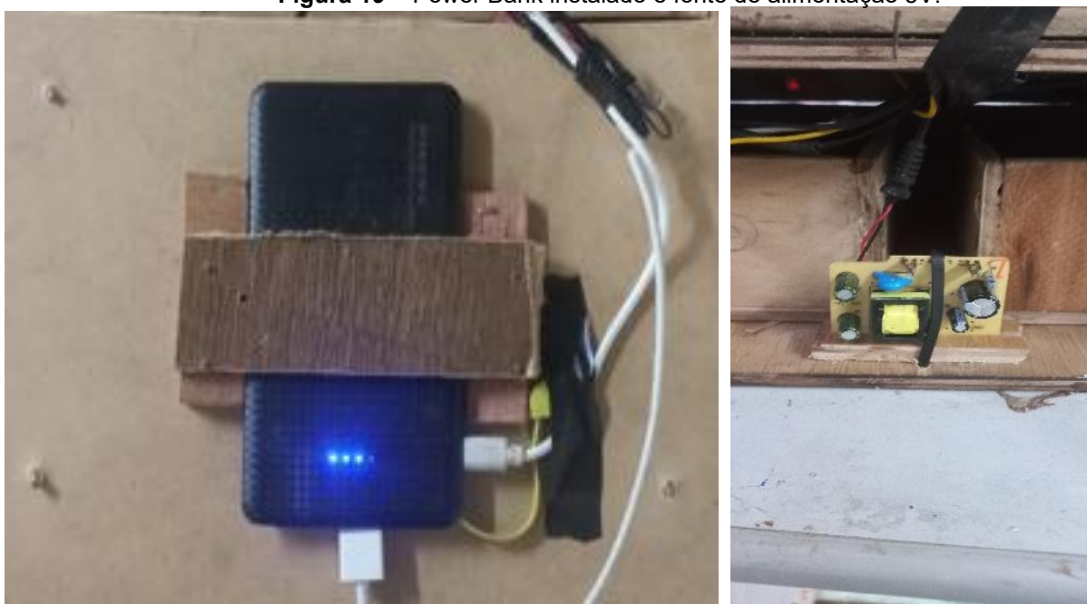
Figura 19 – Power Bank instalado e fonte de alimentação 5V.
