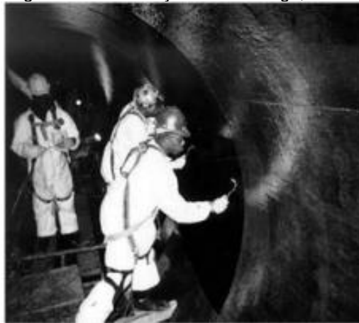
Figura 24 – Tubulação em Chicago, EUA.
