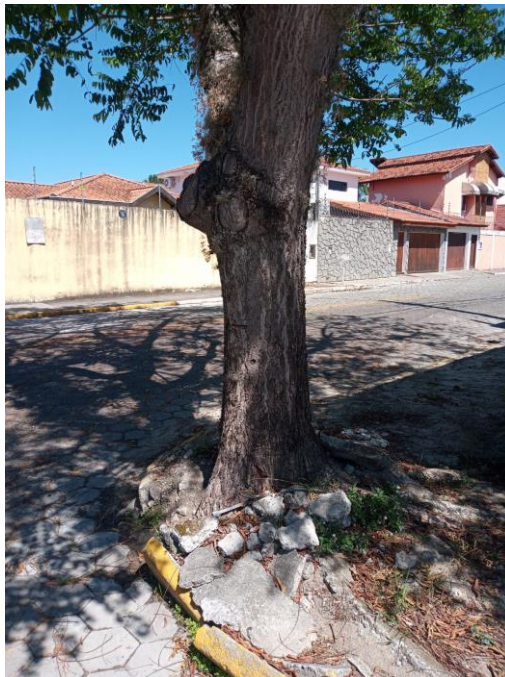
Figura 21 – Calçadas danificadas devido o canteiro inadequado ou falta dele.
