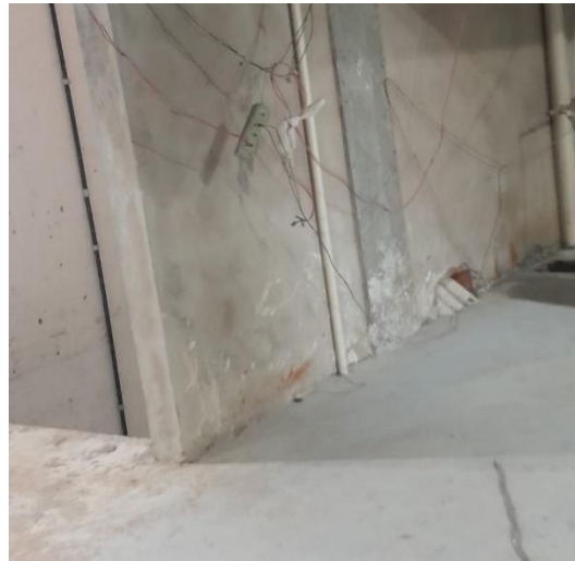
Foto 4: Amaranhado de fios elétricos pendurados na garagem
