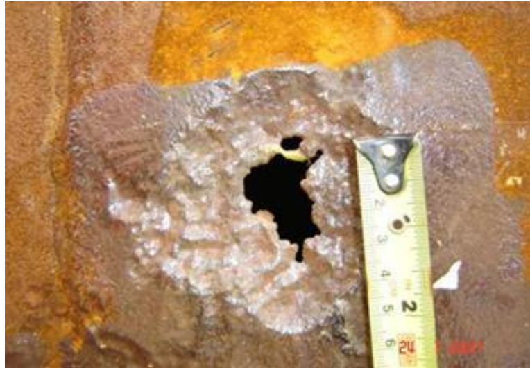
Figure 64: Corrosão no tanque
