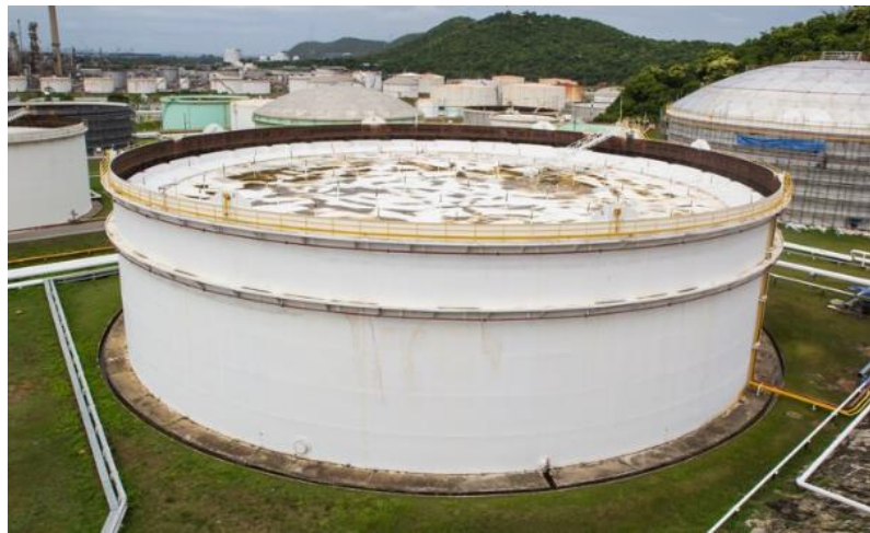
Figure 3: Teto do tanque com solda fragilizada
