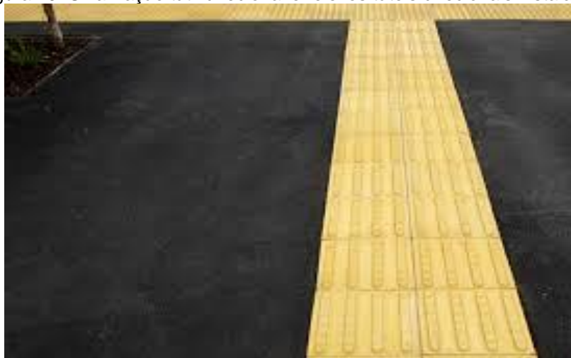
Figura 19: Sinalização tátil direcional e relevos táteis direcionais instalados
