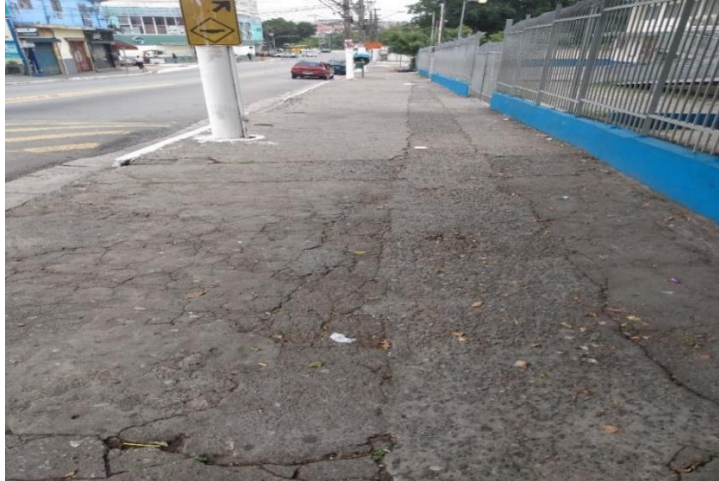
Figura 7: Calçada da UBS/AMA Jardim Brasília deteriorada.
