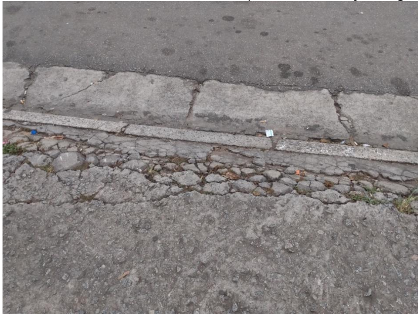
Figura 5: Portão 2 do AMA Jardim Brasília sem rampa e sem sinalização de guia rebaixada
