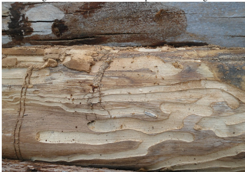
Figura 1 - Madeira deteriorada por insetos e fungos
