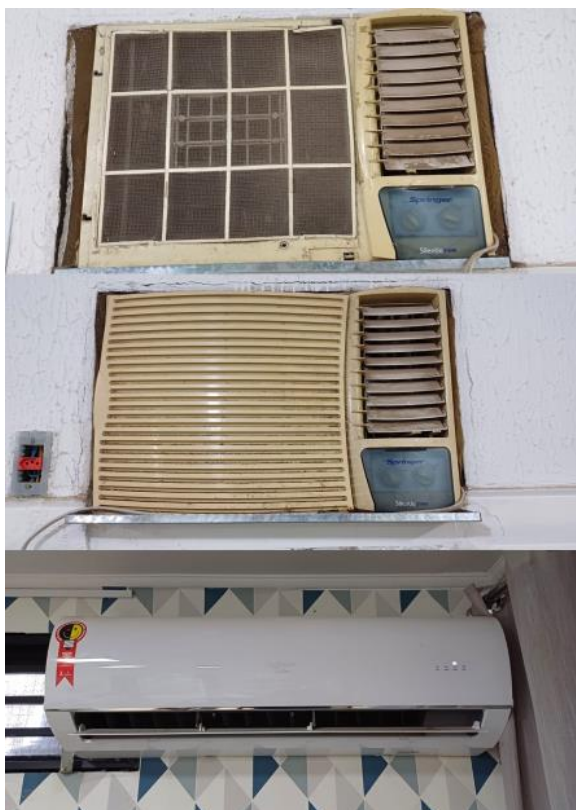
Figura 05: Ares-Condicionados – Fonte Autor dia 17/10/2023
