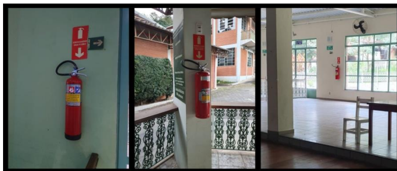
Figura 45: Extintores de incêndio
