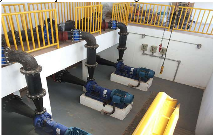
Figura 4 – Estação elevatória de água com motobombas
