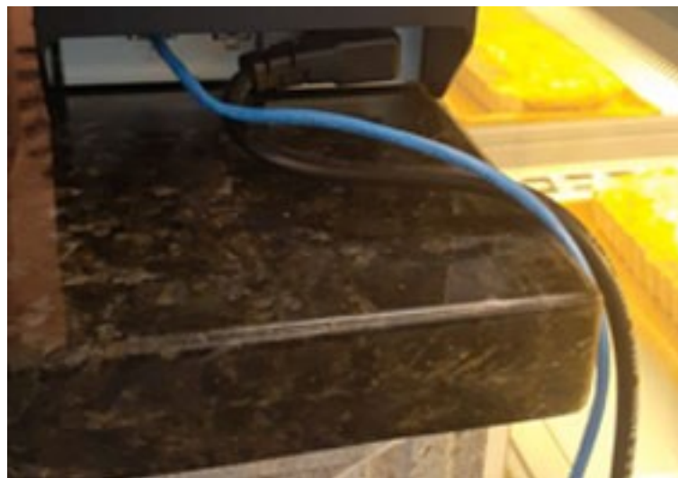
Figura 7 – Ausência de patch cords nos equipamentos
