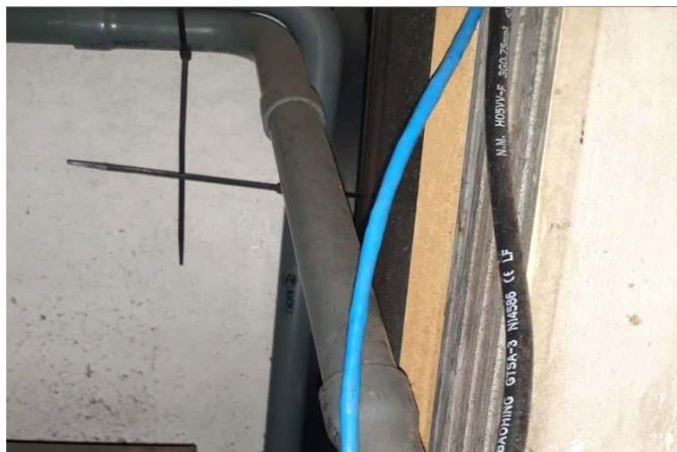
Figura 6 – Cabos de rede próximos à rede elétrica e hidráulica
