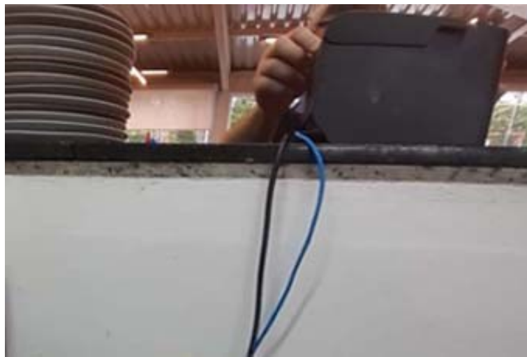
Figura 4 : Cabos das balanças BLA desprotegidos
