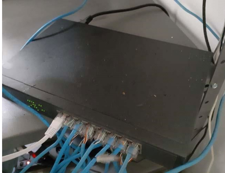
Figura 11 - Switch SW01 desprotegido e posicionado de forma inadequada
