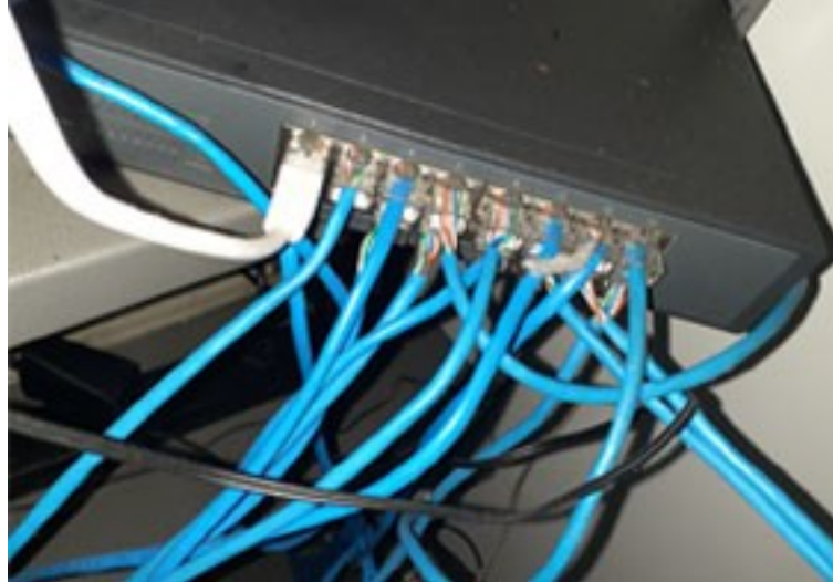
Figura 2 - Cabos na saída do switch SW01 desprotegidos
