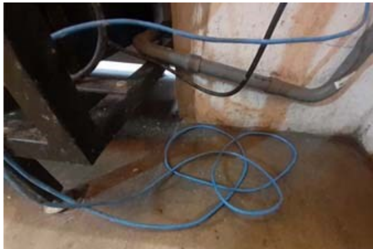
Figura 3 : Cabos de rede soltos no piso
