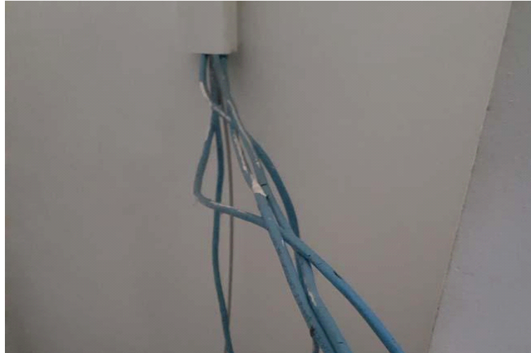
Figura 5: Cabos de rede destinados aos equipamentos com fixação inadequada
